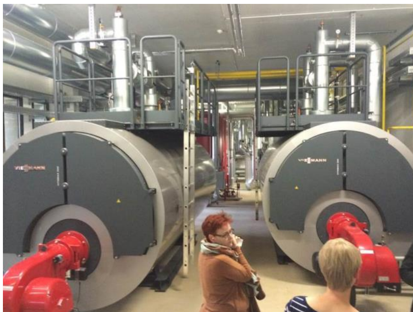
Abb. 7: Wärmeversorgung FH Lübeck: Viessmann, 2 Kessel à 4,9 MWth, Erdgas
