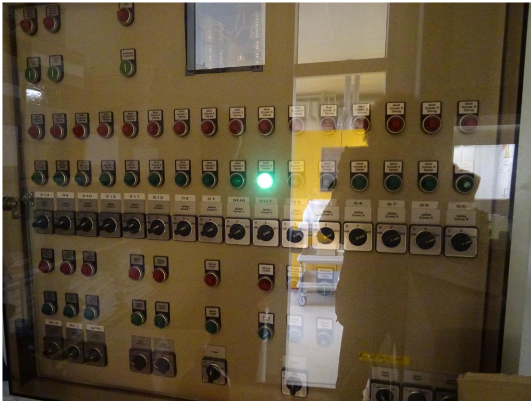
Abb. 42: Schaltschrank Lüftung VE 13_ Verf.-Bau I (Geb. 13)
