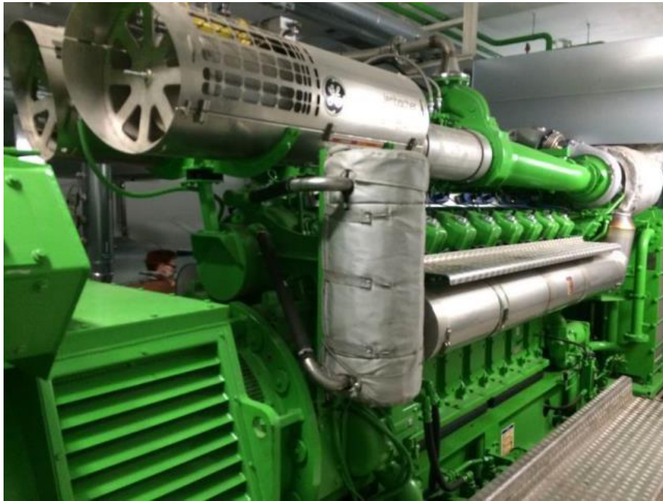
Abb. 8: Jenbacher (GE) BHKW mit 2,5 MWel, virtuelles Biogas (EEG)
